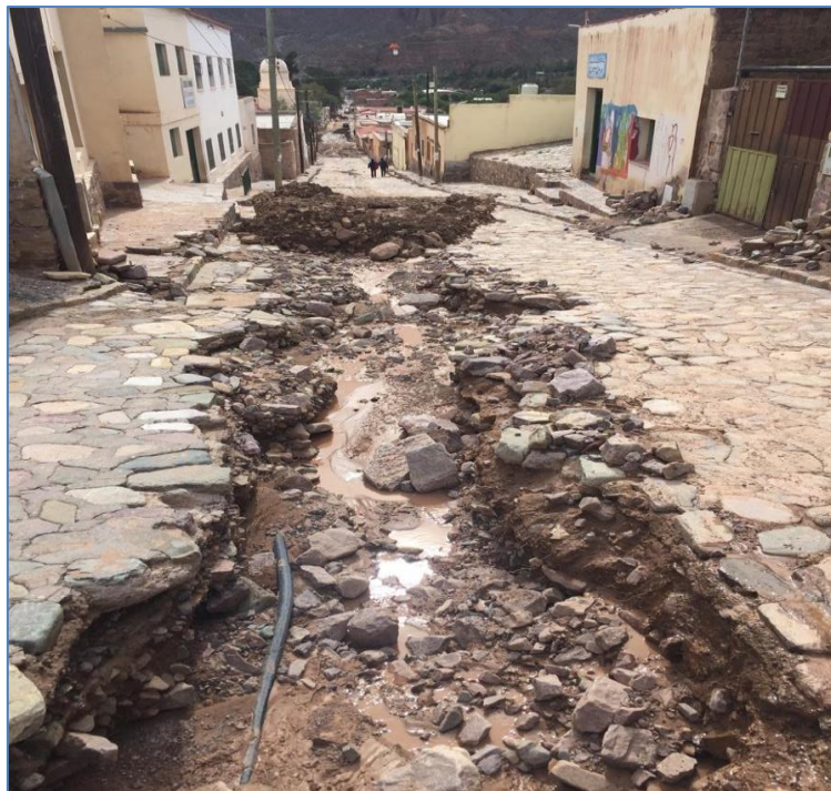
Figura 4. Calle Lavalle, próxima al centro de Tilcara. Alud de marzo de 2017
